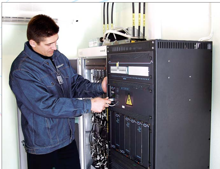
Базовая станция – это не только антенна, но и блок с коммуникационным оборудованием
